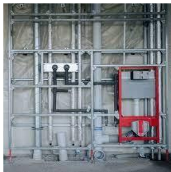
Concealed Plumbing Pipe / Скрытая водопроводная труба
